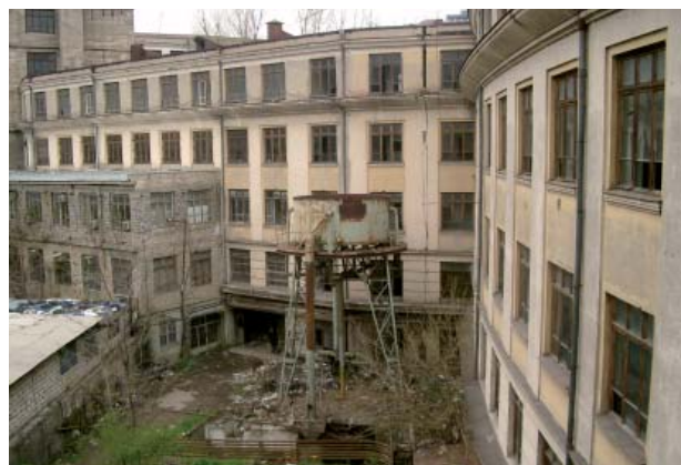
Bild 59: ..... der Innenhof eine Schrotthalde - Beispiel ein Gebäude der TU Tbilisi, 2004
