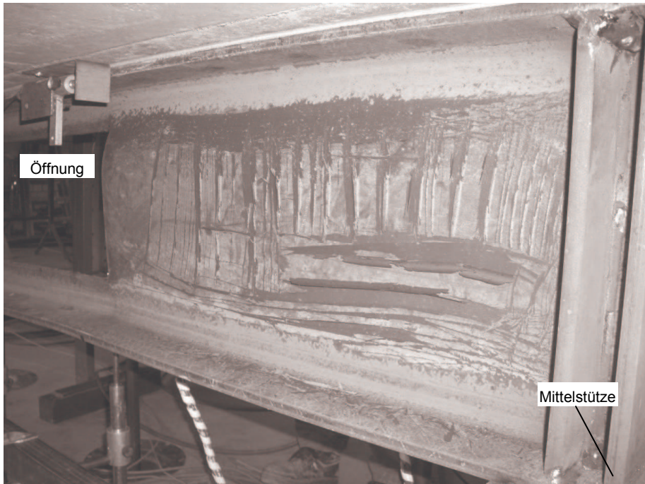
Bild 4–57: Bereich des Stahlträgers zwischen Mittelstütze und Öffnung bei V4-S400 (Bruchzustand)
