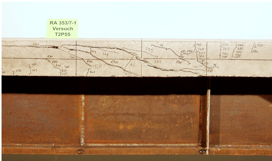
Abb. 5.30: Querkraftversagen des Betongurts bei Versuch T2P55 (Die Stegöffnung wurde nachträglich für Folgeversuche mit einem eingeschweißten Blech geschlossen)
