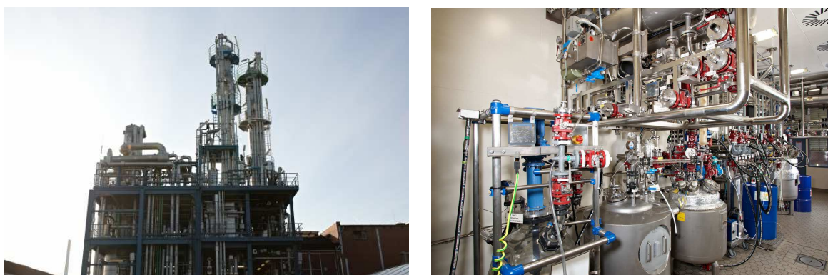
Abbildung 4 und 5. Vielzweckpilotanlage der Saltigo GmbH im Pilotierungsbetrieb ZeTO .
