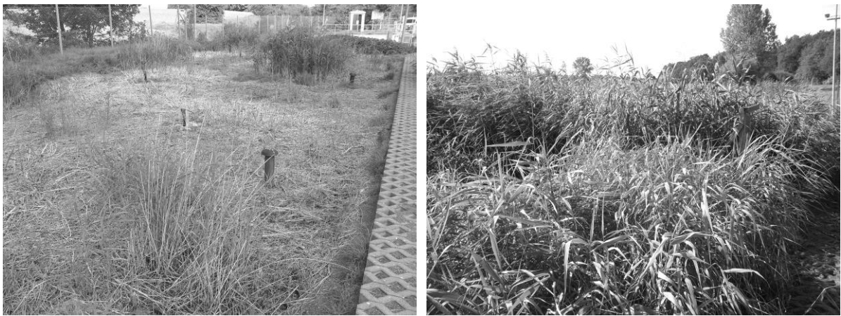
Bild 5.41: Bewuchs der Hauptbodenfilter der Kläranlage Riesweiler vor und nach der 2012 durchgeführten Einstaumaßnahme (Foto links: 19.09.2011, Foto rechts: 29.08.2012)
