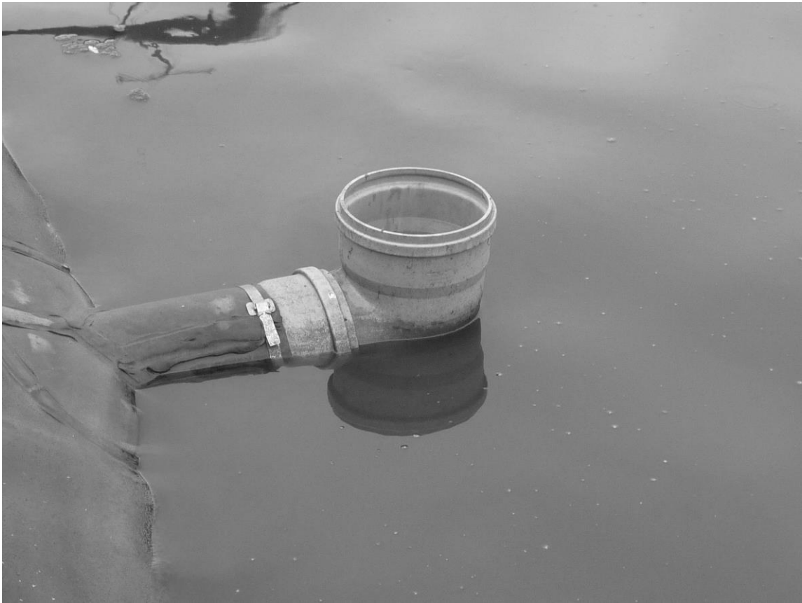
Bild A9.5: Kläranlage Büschdorf – Überlauf zum Ausweichbodenfilter
