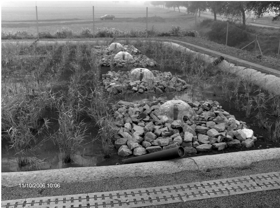
Bild 4.4: Beschickungssystem des ABF der Kläranlage Seyweiler
