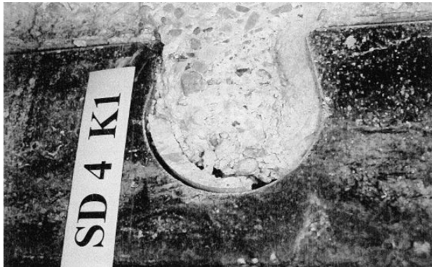
Abb. 2-3: Betondübel mit zerstörtem Betongefüge (aus Wurzer 1997)
