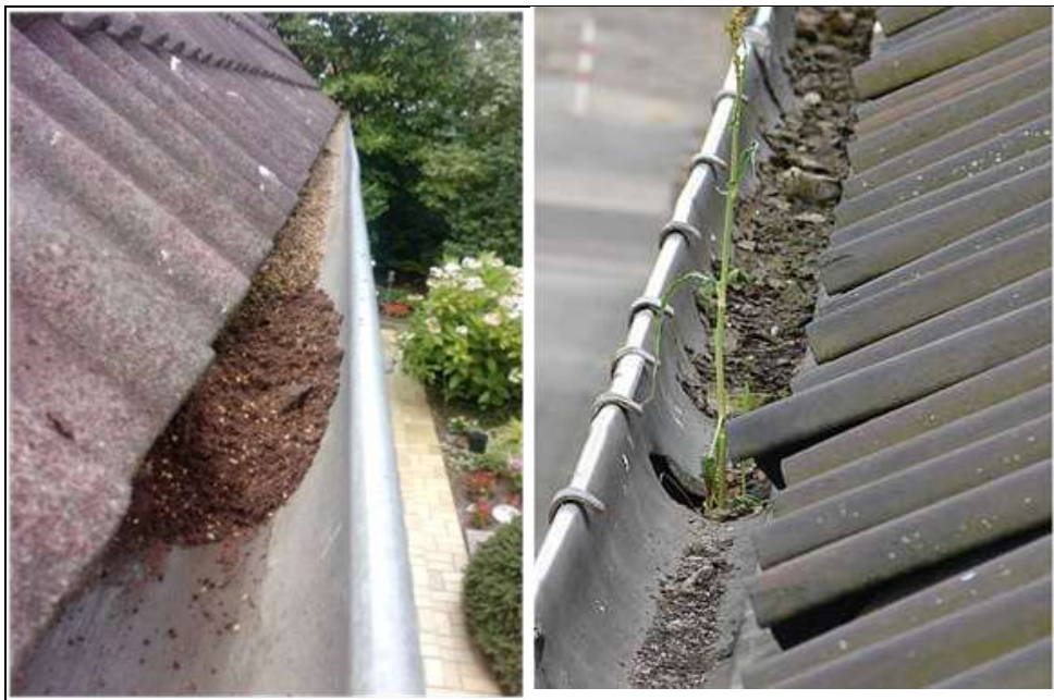
Bild 2-14: Material in Dachrinnen; Fotos: links: [FS-Dienstleistungen, 2013] rechts: [Dachrinnenreinigung Seyffarth, 2013]
