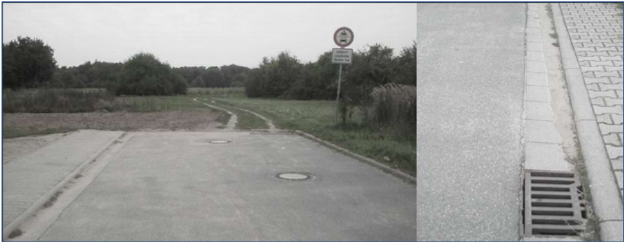
Bild 5-22: Feststoffeintrag durch Bodenerosion im Einzugsgebiet des Regenklärbeckens Mörfelden-Süd, aus [Schmitt, 2013]
