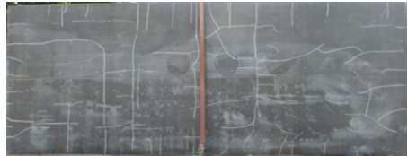
Abb. 5.80: Wand S nach 18 Tagen
