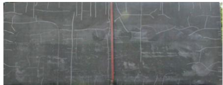
Abb. 5.82: Wand S nach 45 Tagen
