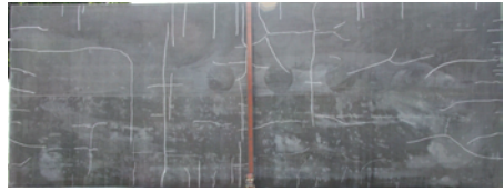
Abb. 5.78: Wand S nach 9 Tagen
