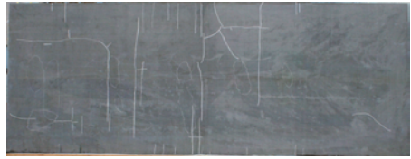
Abb. 5.76: Wand S nach 2 Tagen
