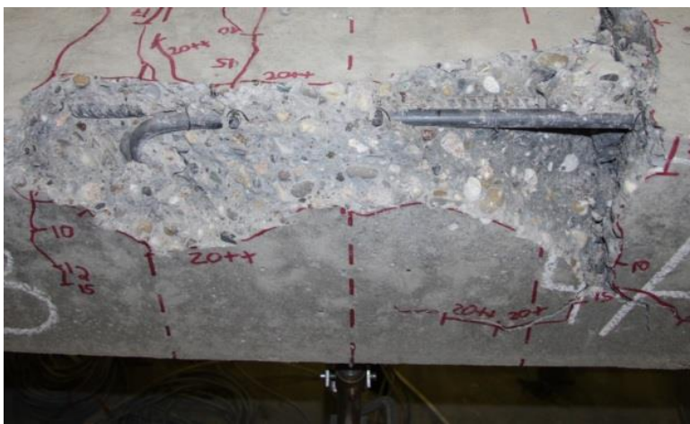
Bild 3.7: Abplatzen der Betondeckung am äußeren Haken (Balken R4)
