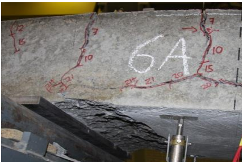
Bild 3.5: Versagen durch Biegedruckbruch infolge Stahlfließens (Balken R6)
