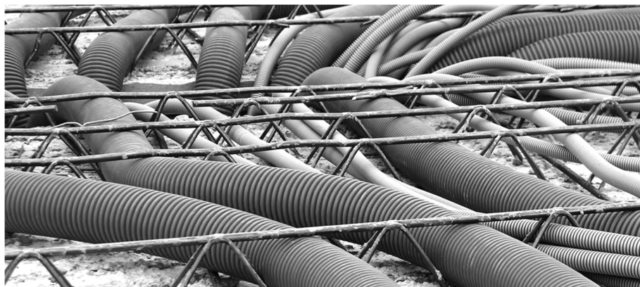
Abbildung 4-2: Beispiel für die praktische Anwendung von Leitungen in Elementdecken [www.spitzer-installationen.at (15.01.2014)]
