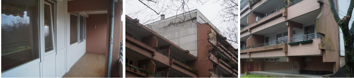
Bild 13: Neue Fenster (l.) und verunreinigte Außenwandflächen (m., r.) (Immobilie 1)
