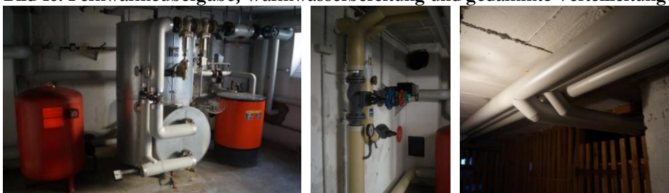
Bild 16: Fernwärmeübergabe, Warmwasserbereitung und gedämmte Verteilleitungen (Immobilie 2)
