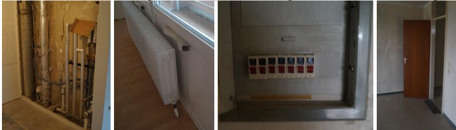
Bild 14: Installationsleitungen, Heizkörper, Sicherungskasten, Deckenoberbelag und Innentür (Immobilie 1)
