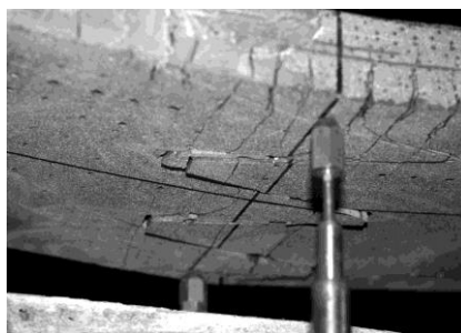
Abb. 5.77: Rissbild auf der Probekörperunterseite bei Versuch B2-FJ- D2-WSG-75-01
