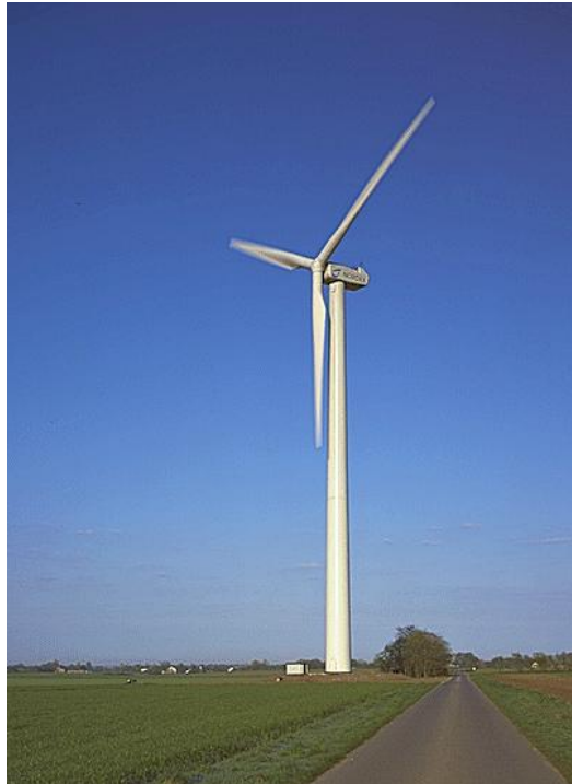
Bild 1-5 Windkraftanlage mit ca. 1,3 MW Leistung, Flügellänge 30,5 m [28]
