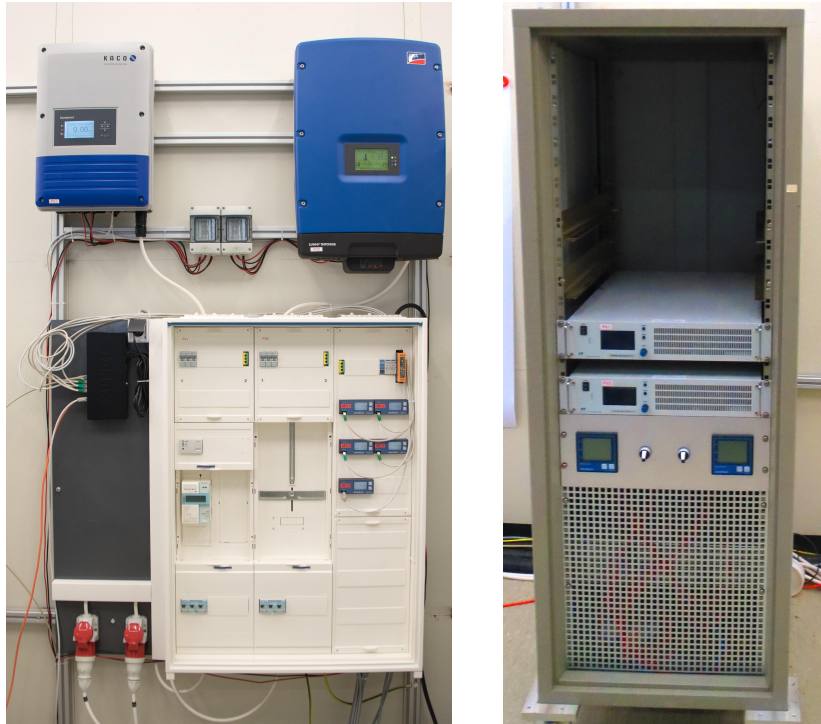
Abbildung 15.4: PV-Nachbildung bestehend aus zwei Wechselrichtern der Hersteller KACO und SMA (links) und zwei 10 kW DC-Quellen zur Speisung der Wechselrichter (rechts)
