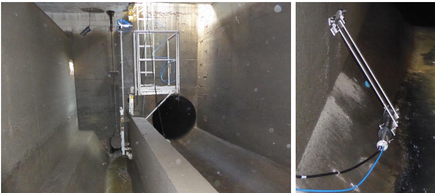
Abb. 4.4: Trennbauwerk des RÜB 1 (links) und eingebaute Spektrometersonde in der Trockenwetterrinne des RÜB 1 (rechts)
