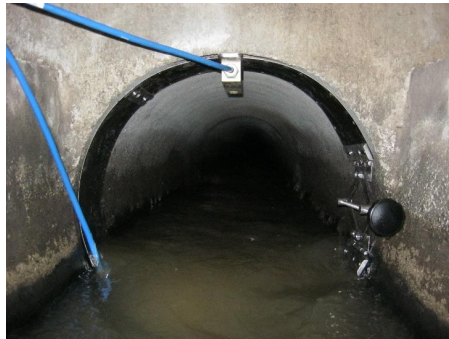
Abb. 4.1: Temporäre Durchflussmessung im Kanal am RÜB 2 Foto: NIVUS GmbH
