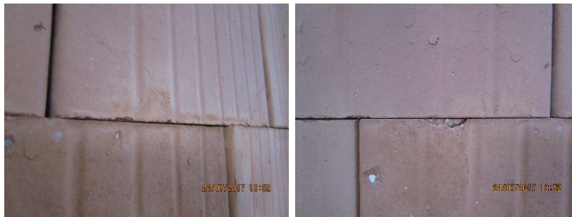
Abbildung 4.27: Kleine Ausbrüche der Kanten in der 7. Fuge
