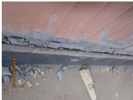
Abbildung 4.23: Stark geschädigte Fuge am Wandfuß
