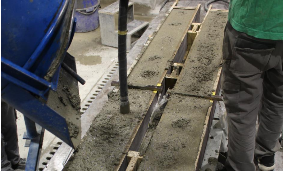
Abb. 3-6: Einbringen des Betons mit Kübel und Verdichten des Betons in der Schalung
