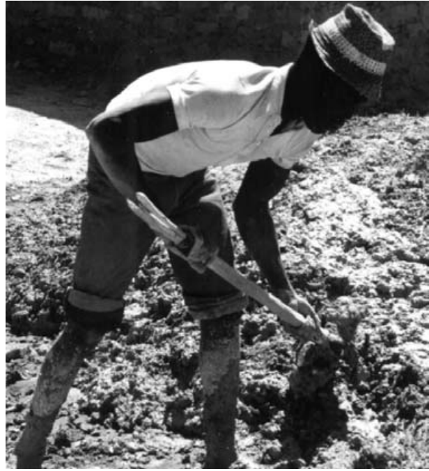
Herstellung des Baustoffes durch Anmischen von Lehm mit Wasser und armierendem Hirsestrohhäkel
