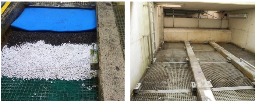
Abbildung 1: Mehrstufiger Aufbau des Filters (links) und Blick auf die drei Straßen und das senkrecht angeströmte Wehr im Zulaufbereich des TRF Fleute (rechts)
